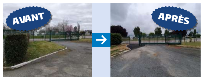
Portail électrique pour l'accès aux visiteurs
